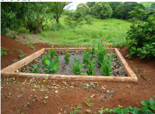
ETE em 2010 em funcionamento
