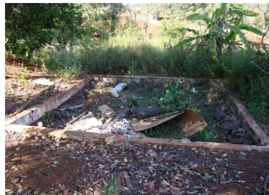
ETE abandonada em 2014 (entulhos)
