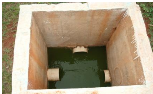
FIGURA 6 – Caixa de passagem de efluente
