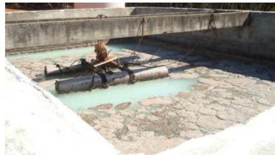
FIGURA 3 – Tanque de equalização.
