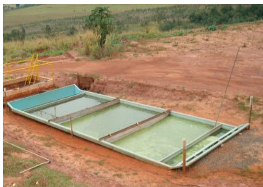
FIGURA 8 – Tanque de polimento (coagulação-floculação-sedimentação).
